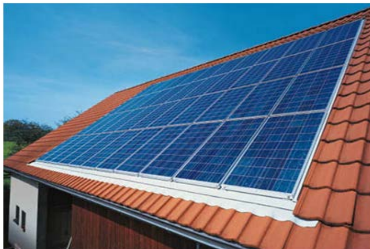
FIGURE 2.9– Panneaux photovoltaïques installés sur le toit d'une maison.
