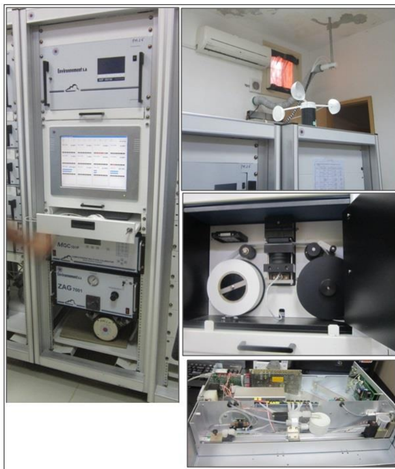
Figure 51 : Analyseurs automatiques installés au sein d'une station de mesure (exemple de la station périurbaine du Parc Mourouj). (Photos : Ben Romdhane S., 2012).
