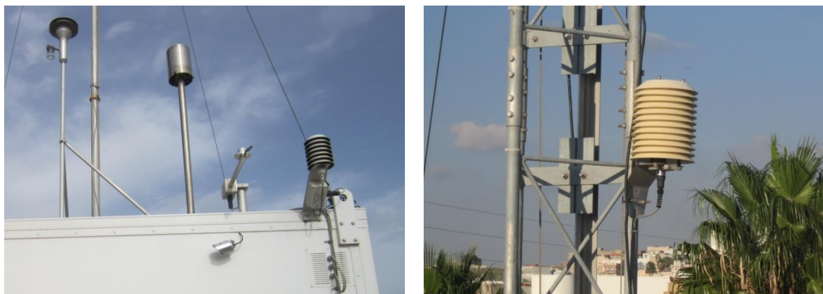
Figure 50 : Têtes de prélèvement des polluants disposées sur une cabine (station urbaine d'El Ghazela (à gauche) et la station périurbaine de la qualité de l'air du Parc Mourouj (à droite)). (Photos : Ben Romdhane S., 2012).
