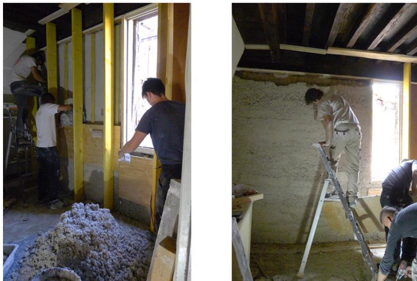
Figure 9 : Mise en œuvre du chaux-chanvre banché avec les élèves de la Chambre des Métiers du Lot dans les appartements tests du projet ENERPAT, septembre 2017
