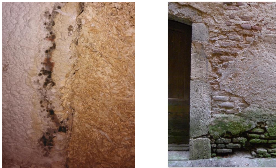
Figure 73: Observations de micro-organismes à Cahors : Développement de moisissures sur la surface intérieure du mur à proximité du chaux-chanvre quelques semaines après la pose (gauche). Mousse en partie basse de la façade extérieure (droite).
