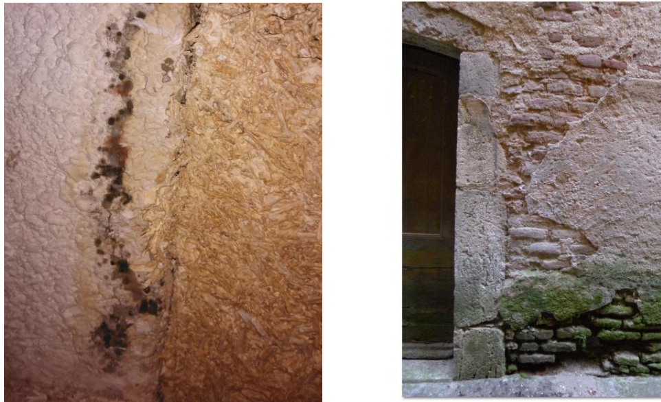
Figure 73: Observations de micro-organismes à Cahors : Développement de moisissures sur la surface intérieure du mur à proximité du chaux-chanvre quelques semaines après la pose (gauche). Mousse en partie basse de la façade extérieure (droite).
