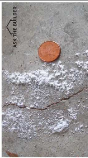
Fracture dans le ciment
