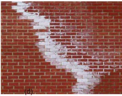
(d) Efflorescence (Croute)
