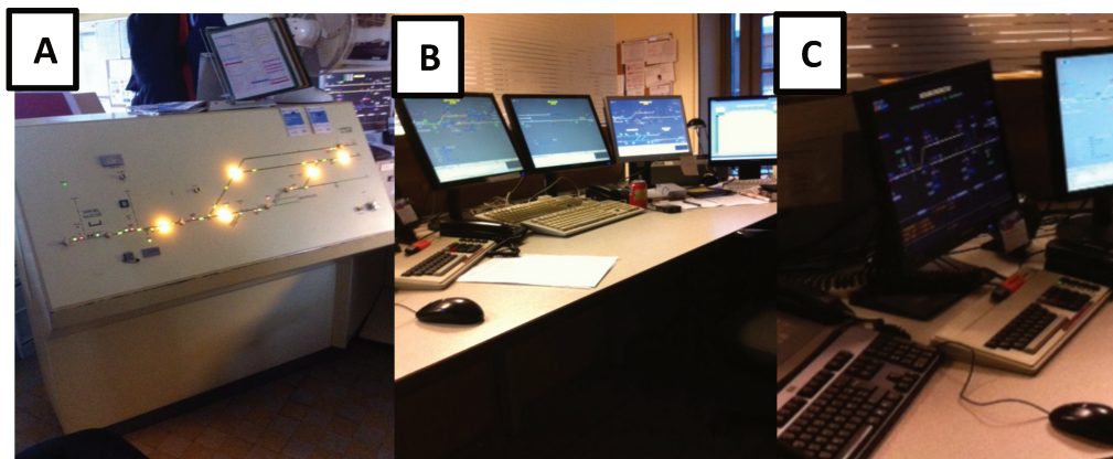
Figure 8 : Les trois générations de système de gestion des circulations : PML (A), PIPC (B) et PRCI (C)
