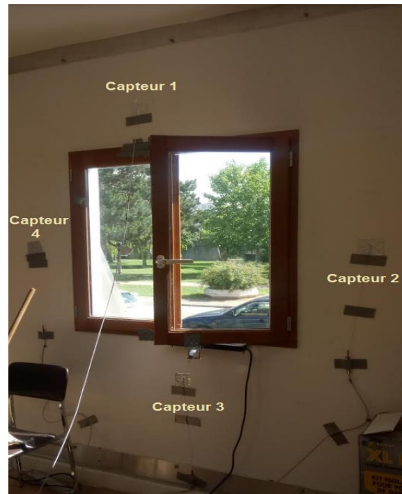
Figure III-62 : Capteurs de température de surface intérieure
