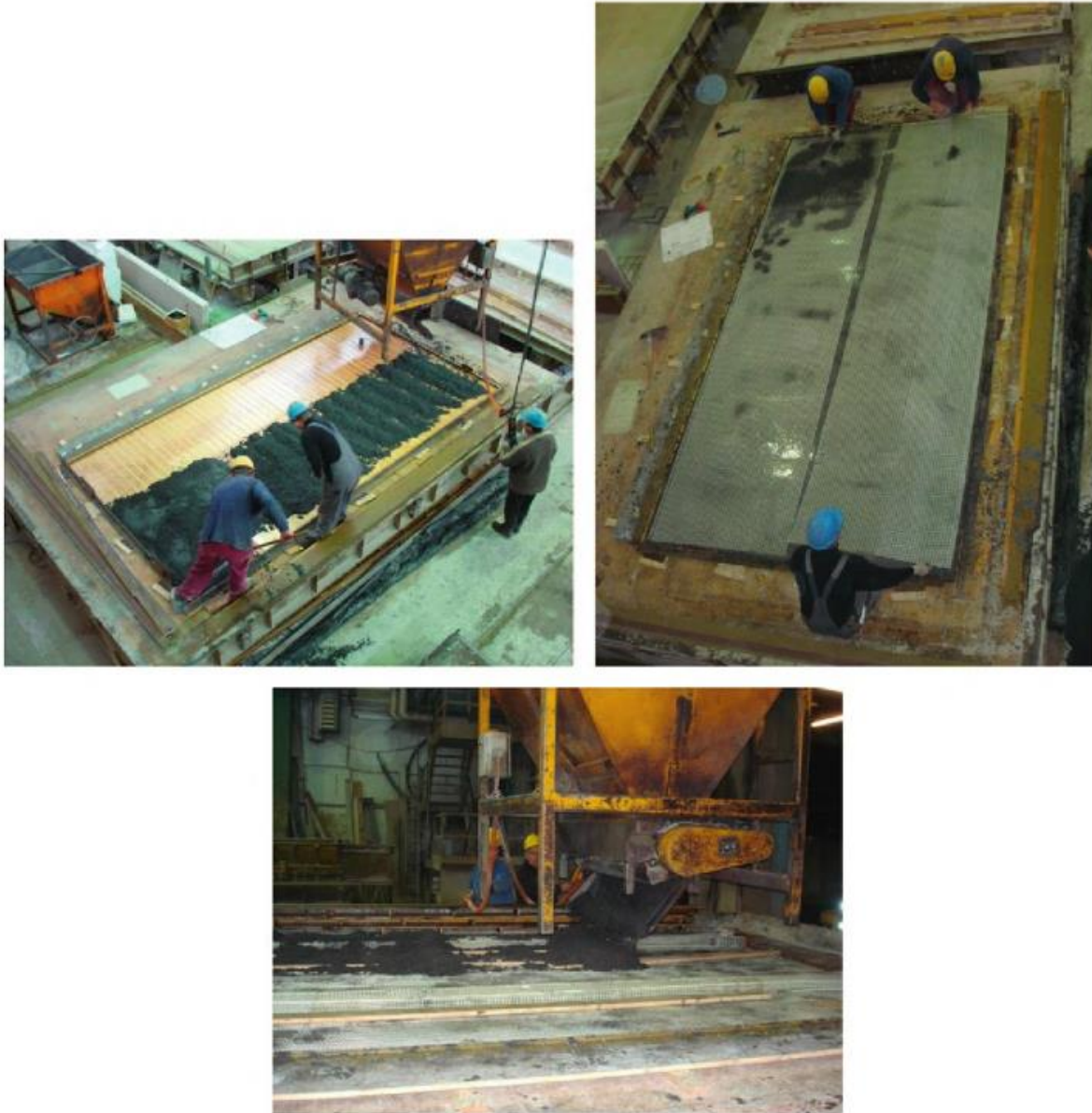
Figure II-22 Fabrication de panneaux de façades par la technique de stratification (Brameshuber et al.,2016)
