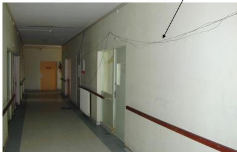
Figure 3. 27: Photo d'époque montrant le couloir montrant aussi les câblages de la chaîne de mesure
