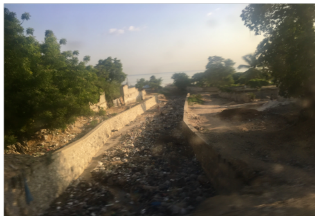
Figure 9 : Photographies de ravines à Port-au-Prince 33
