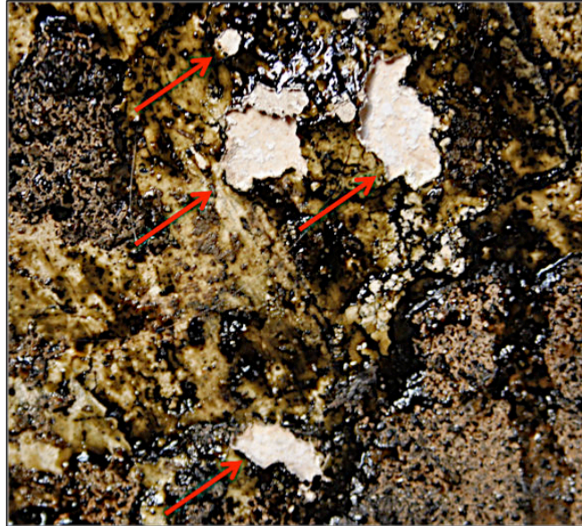
Figure 10 : Le mur de l'église de Vicherey est colonisé et détérioré par des cyanobactéries.
