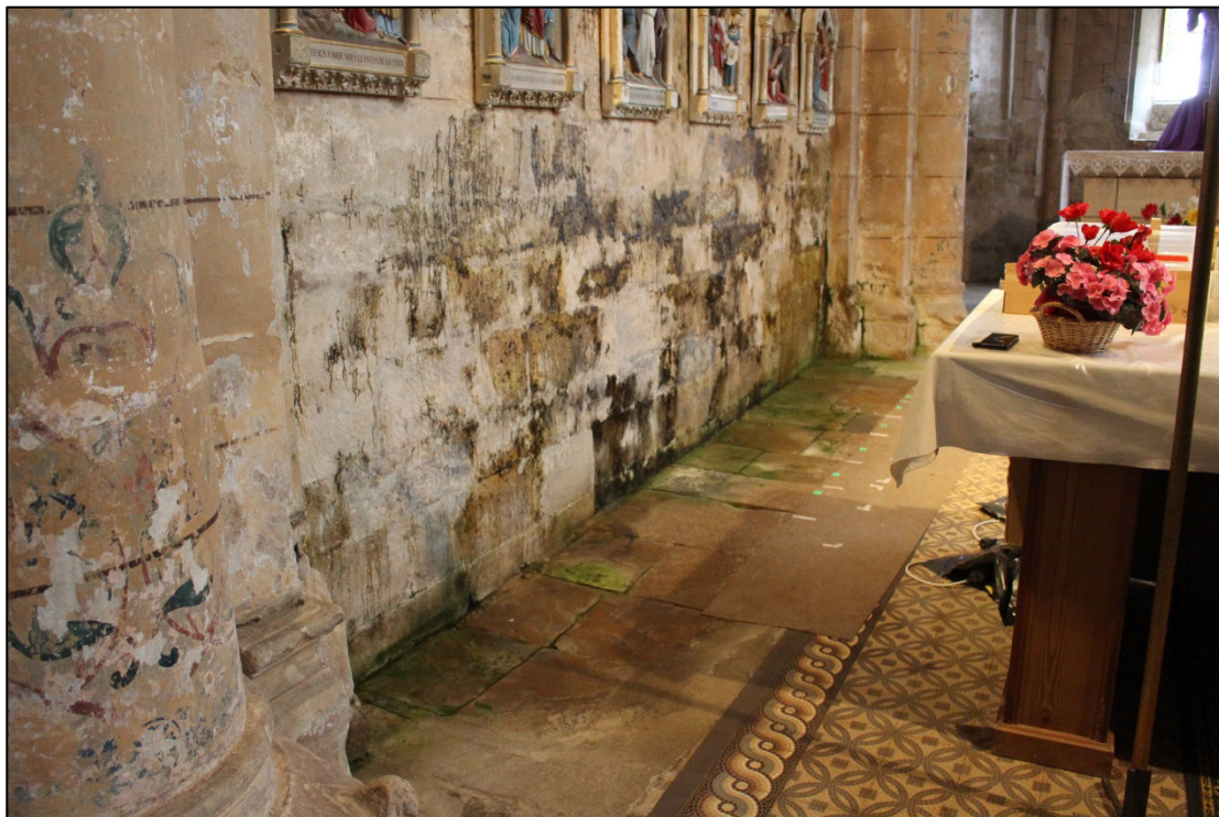
Figure 10 : Illustration de l'intérieur de l'Église de Vicherey. Les biofilms algaux et cyanobactériens sont visibles sur le mur de droite.
