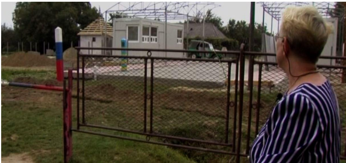
Annexe 1.11.5 : Capture du documentaire Hranica de Jaroslav Vojtek. Image du chantier de construction du check-point frontalier obtenu par les villageois, on distingue clairement les bornes frontalières slovaques et hongroises.
