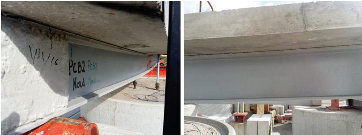
Figure IV-34 : Rupture de la poutre PCB2 par décollage
