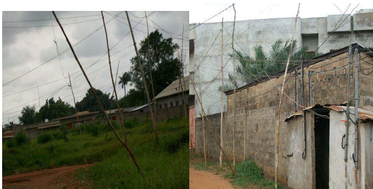
Figure n° 60 : Extension du réseau électrique par la population avec les matériaux de fortune dans le lotissement d'Adjarra première tranche
