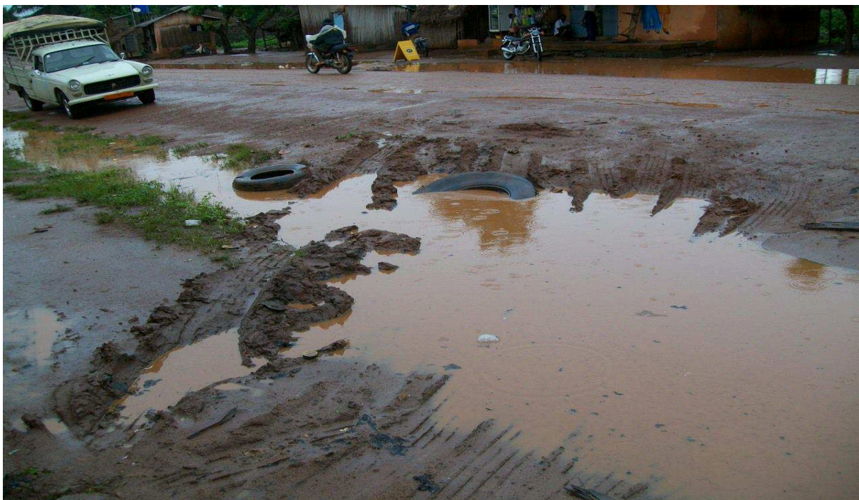
Figure n°61 : Un cas exemple de conduits d'eau bouchés empêchant la circulation sur la voie pendant la saison pluvieuse à Adjarra
