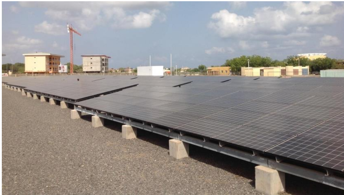
Figure 2.1 - Panneaux solaires photovoltaïques de la centrale
