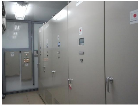
Figure 2.4 - Aperçu des armoires des onduleurs
