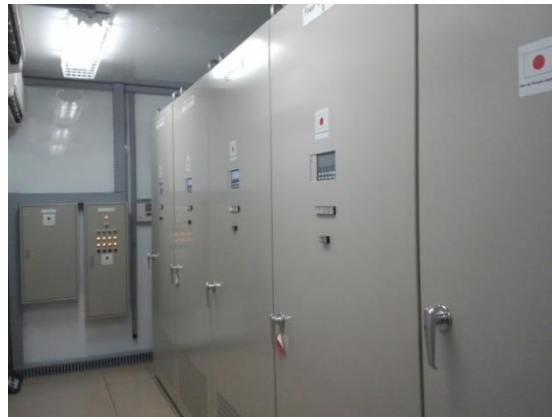
Figure 2.4 - Aperçu des armoires des onduleurs
