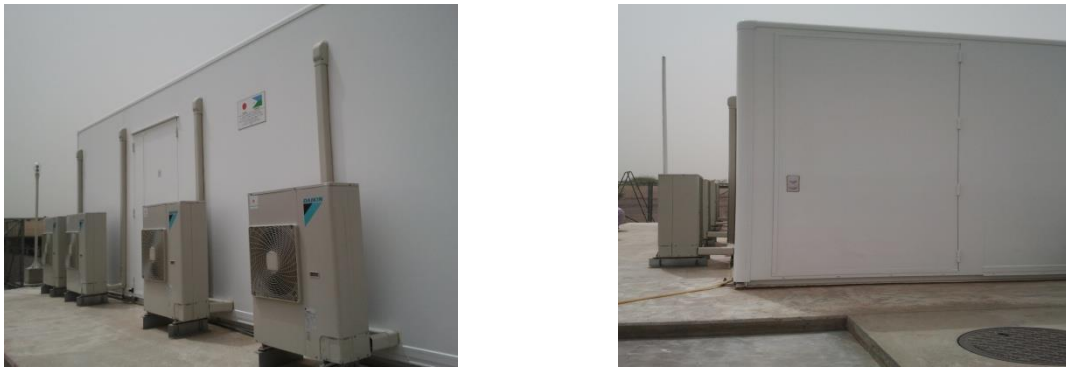
Figure 2.3 - Salle de contrôle
