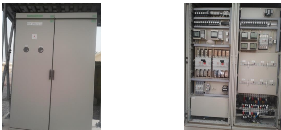
Figure 2.5 - Armoire de commutation des charges
