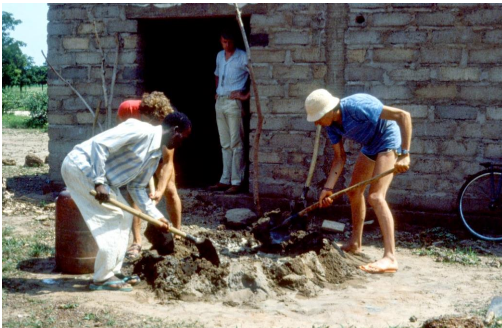
Photo 21 : Volontaires Français et Voltaïques travaillant à la construction de la banque de céréales, Sabou, (Patrick et Sylviane LAURENT, 1982)
