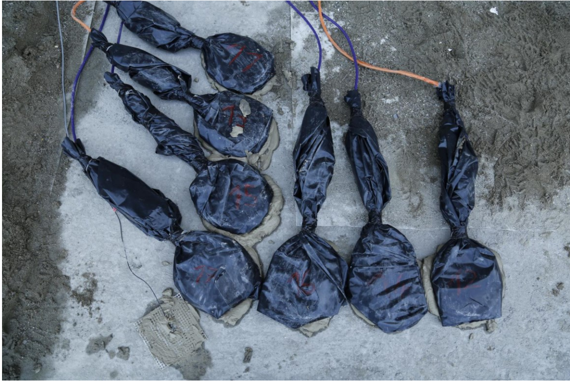
Figure 3.6 : Mise en place des capteurs de pression et d'un des accéléromètres, scellés à la dalle.
