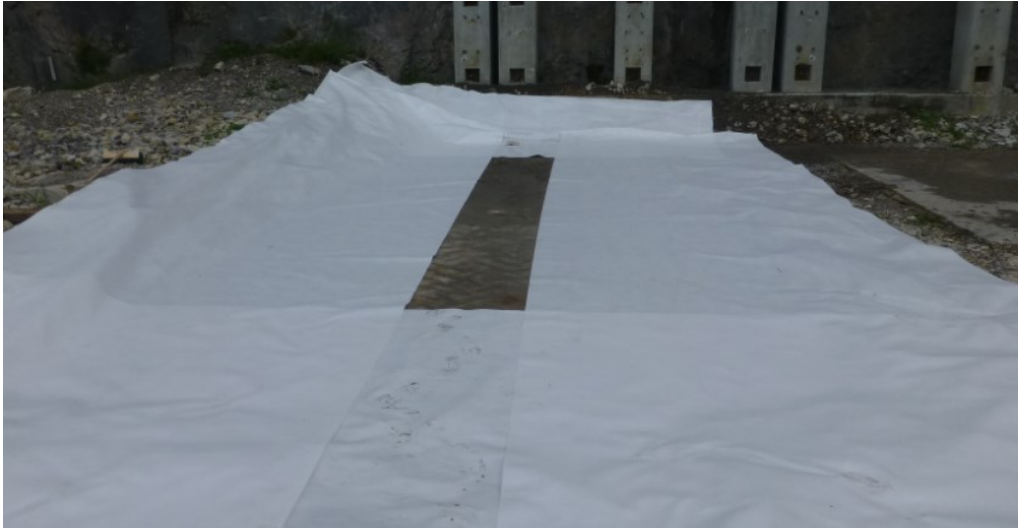
Figure 3.10 : Installation du géotextile de séparation à la surface des dalles et du site
