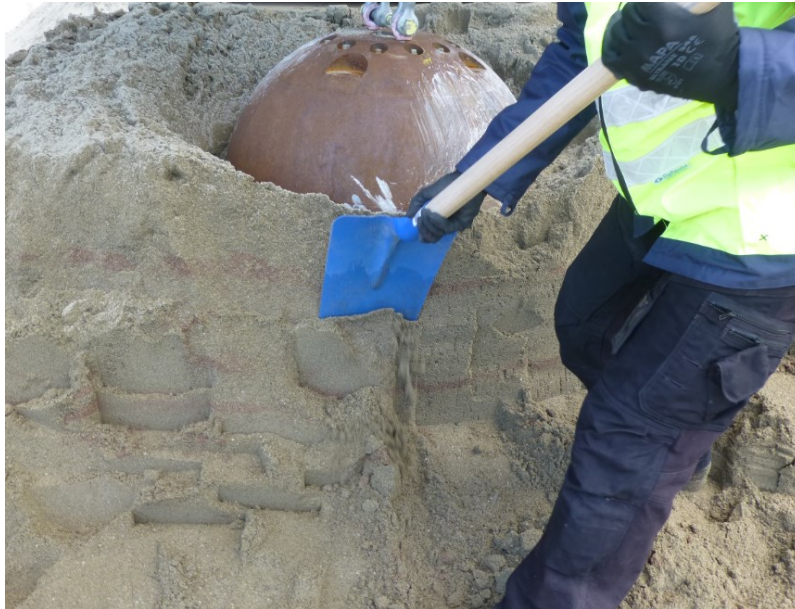
Figure 3.19 : Excavation manuelle du sable dans un plan vertical – Essais préliminaires, remblai B
