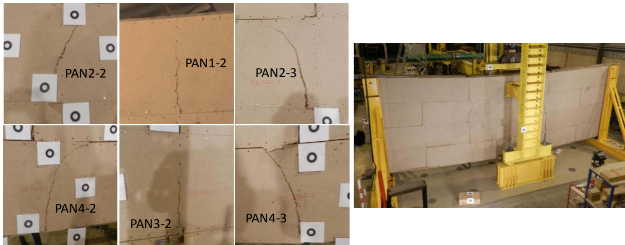
Figure III-34. Détail des ruptures des panneaux du plancher 1.
