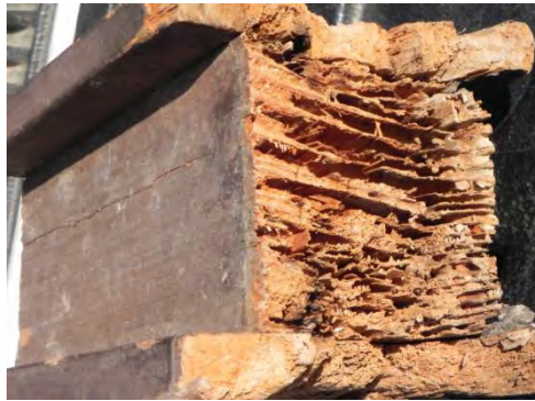
Figure 19 : Dégâts des termites sur une poutre en I utilisée dans une structure (Pestcons wordpress)
