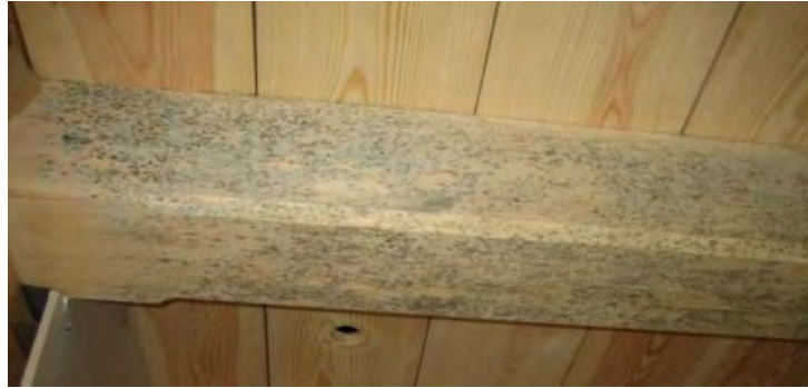
Figure 22 : Bleuissement sur charpente (renovation.fr)
