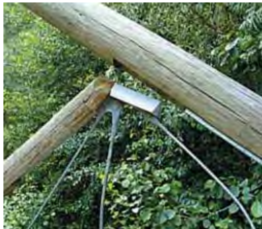
Figure 23 : Rupture au niveau d'un assemblage insuffisant (d'après Aubagnac et al. 2008)
