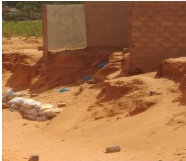
Figure 38: Maison en construction détruite par ravinement sur le quartier de relocalisation suite à une pluie de 130 mm. Cliché: Abdou Alou A. 2017
