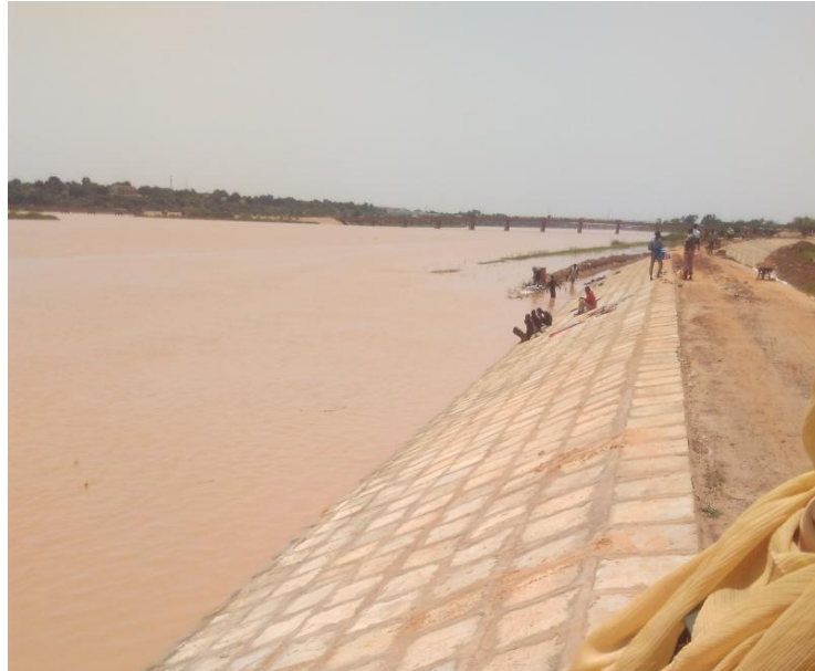
Figure 50: Rénovation de la digue de protection de la ville sur la rive droite. Cliché : Abdou Alou. A. 2017
