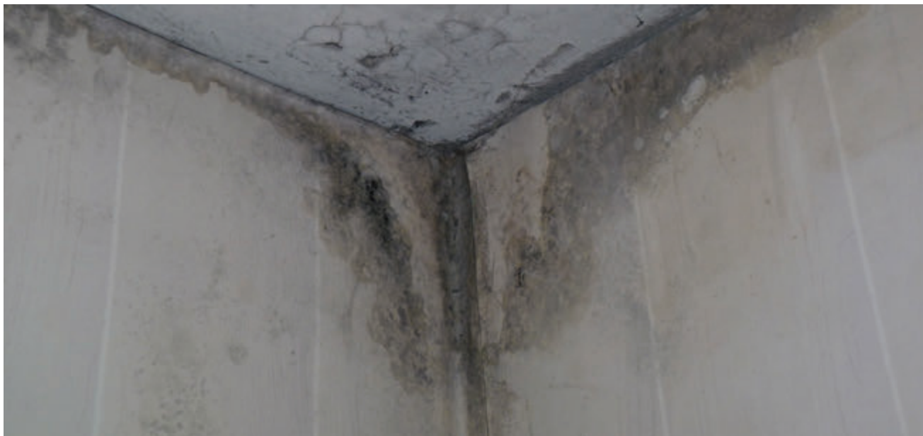
Photo 1-12 Traces de moisissure provoquées par l'humidité de l'isolant par condensation due a un pont thermique à l'angle. Crédit photo : Inconnu
