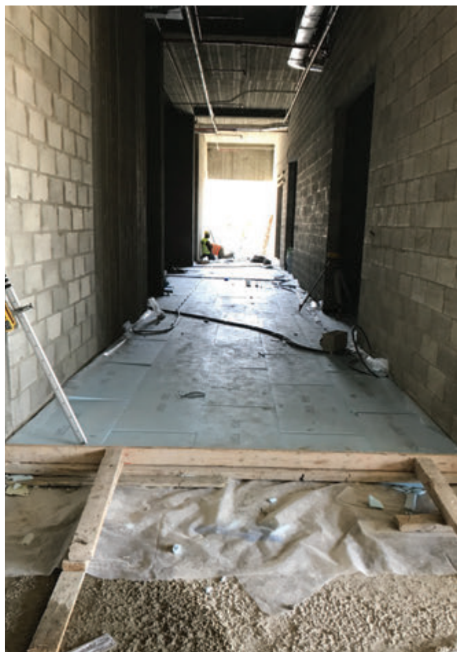
Photo 1-199 Isolation en XPS utilisé sous le dallage sur terre-plein. Crédit : FYu
