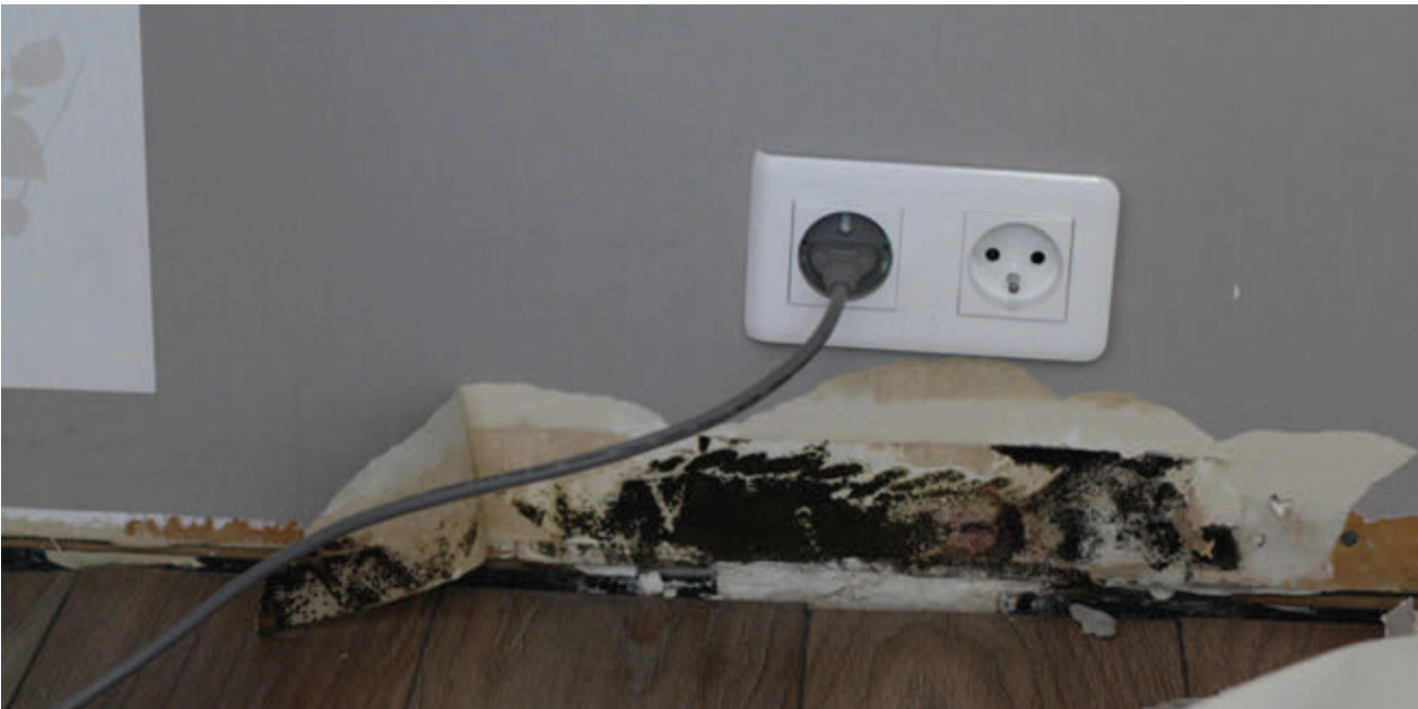
Photo 1-11 Traces de moisissure provoquées par l'humidité dans l'isolant par une condensation due à la migration de l'eau de condensation de la paroi vers le pied de parois. Crédit photo : Inconnu
