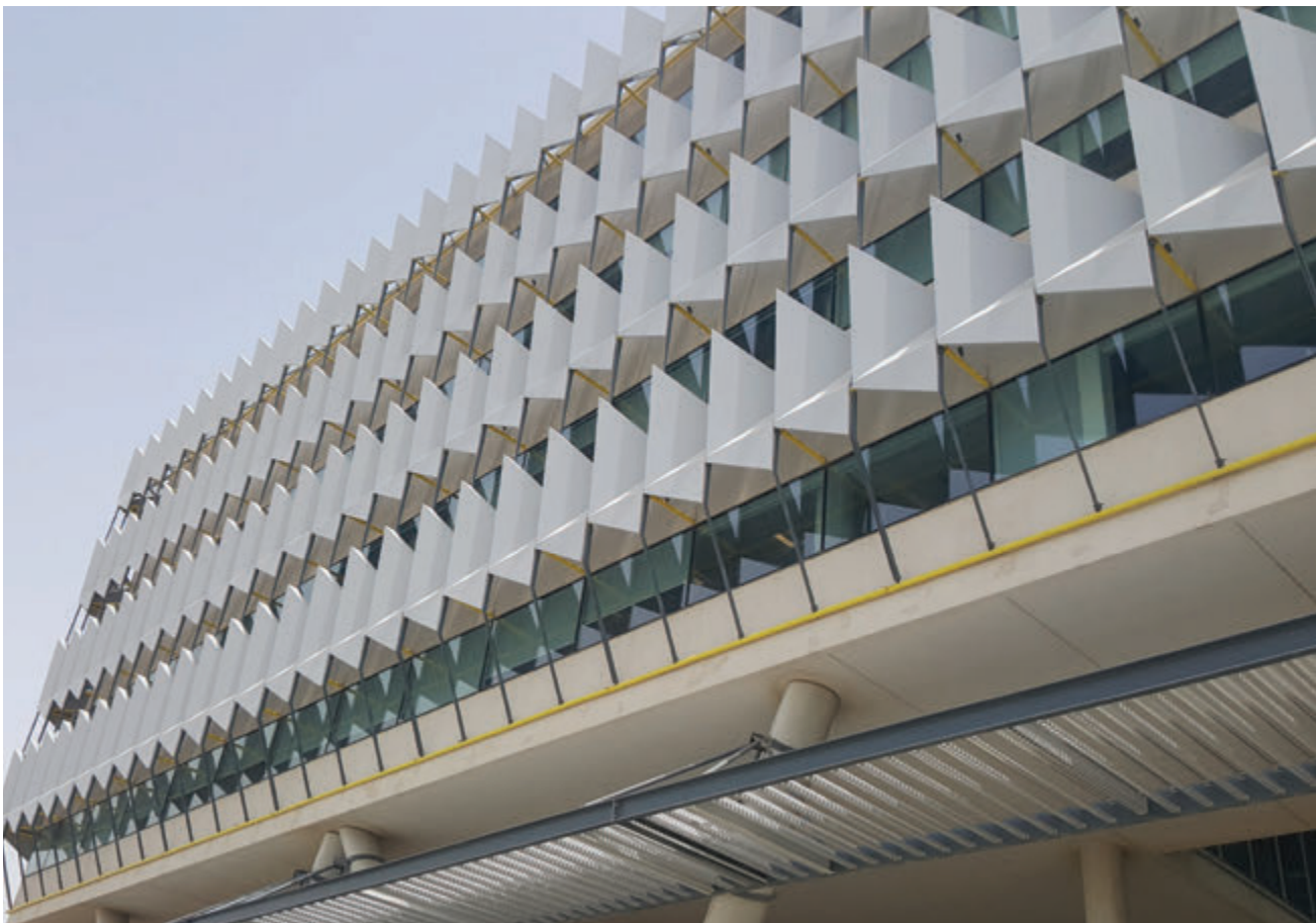
Photo 1-171 Protection solaire en façade des laboratoires par l'extérieur par des éléments textiles. Crédit: NF&A
