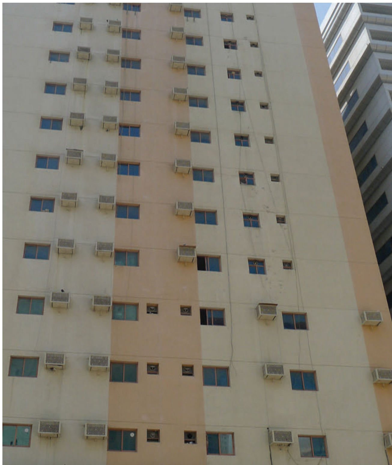
Photo 1-1 Façade maintes fois vue qui montre l'échec de son architecture par l'installation des unités de AC pour pallier la surchauffe non gérée du logement. Sharjah, UAE. Crédit : FYu
