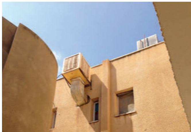
Photo 1-15 Logements collectifs récents à Jéricho avec refroidisseur adiabatique en façade. Crédit : FYu
