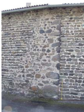
fig. 175. Détail d'un arrachement de mur dans une des maisons du pourtour. Blanzac.
