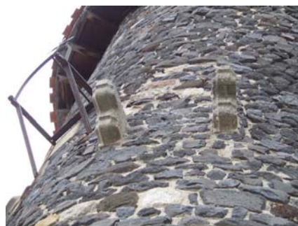
fig. 390. Détail des corbeaux d'une ancienne bretèche sur la tour d'escalier. Le Monastier-sur-Gazeille.
