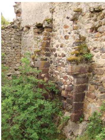
fig. 438. Cheminée ruinée du logis. Agrain. Ouïdes.
