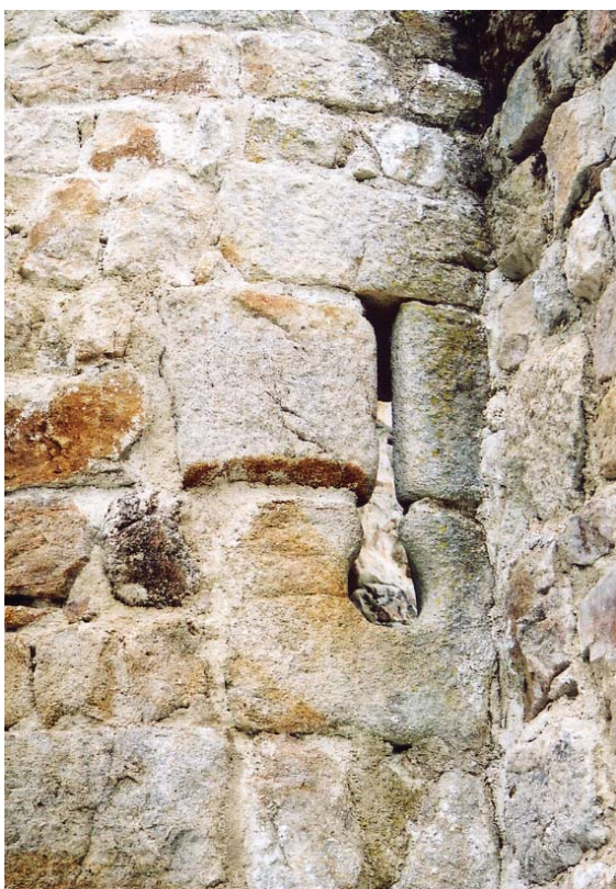
fig. 118. Détail de l'archère-canonnrière de la tour sud, flanquant la courtine ouest. Vue externe. Rochebaron.
