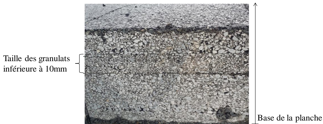
Figure IV-5 Défaut de granulométrie d'une des sous-couches BBSG lors de la construction de la planche-2015
