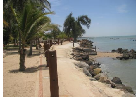
Photo 17 : Enrochement, pneu, mur (Téranga)
