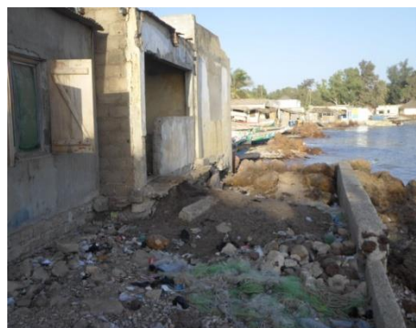
Photo 7 : Maison endommagées à Saly Coulang
