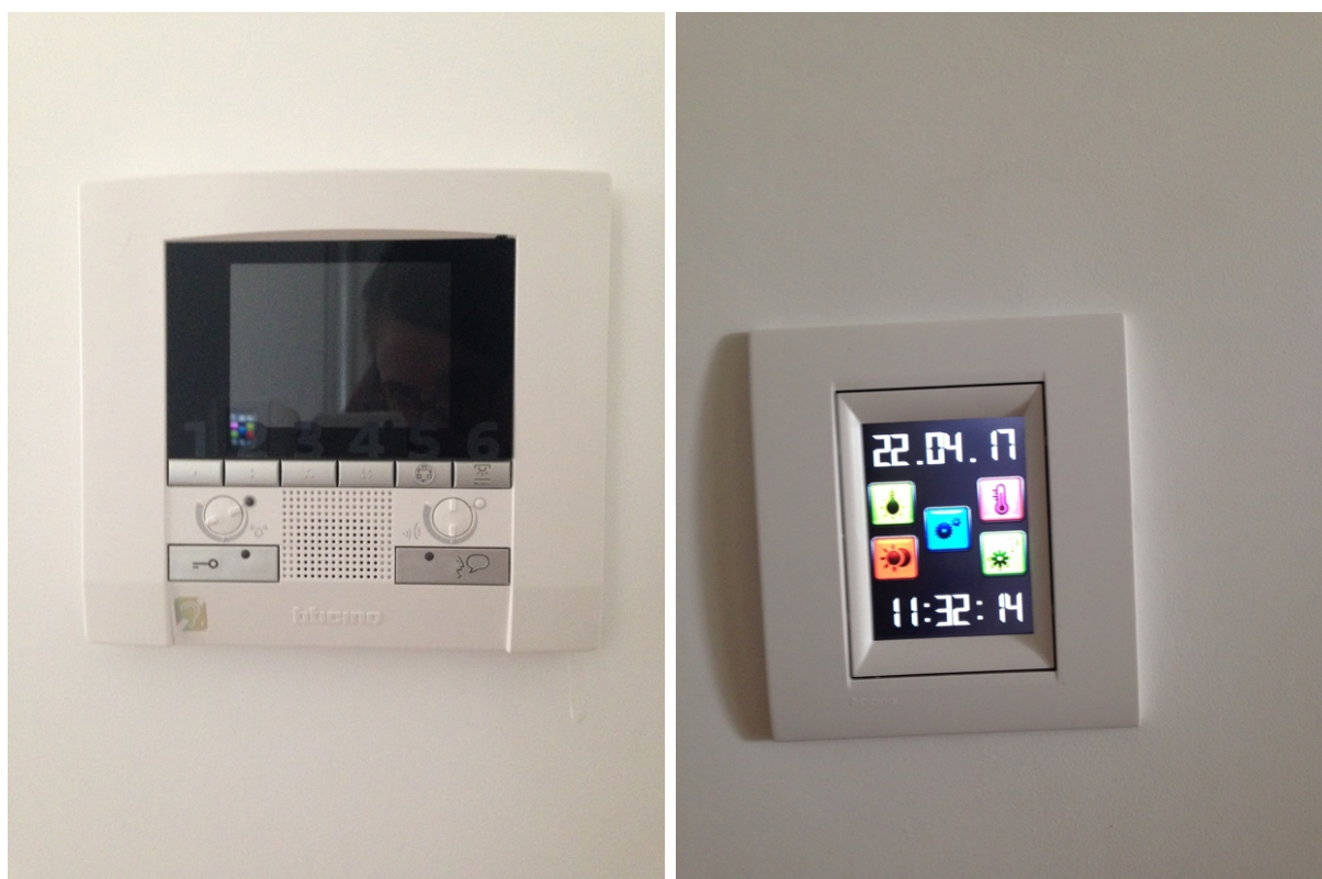
Deux photographies des système domotique au sein de l'un des logements du Fort. Source : réalisation personnelle le 22 avril 2016.
