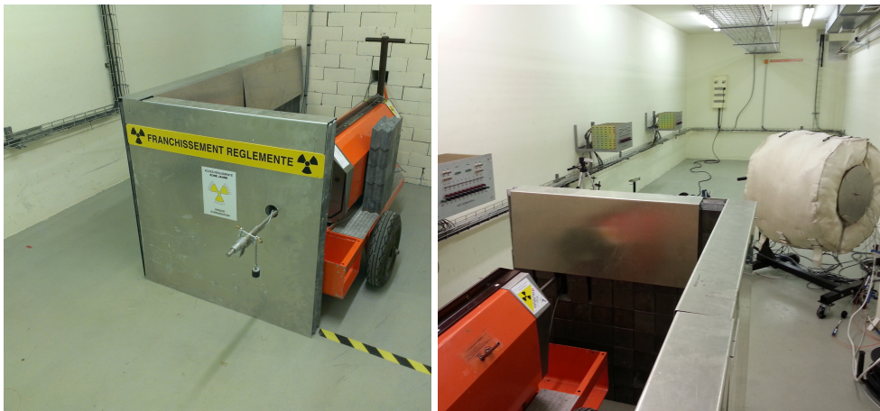
FIGURE 3.14 – La source \text{Co}^{60} est confinée dans l'enceinte du gamma-graphe.
