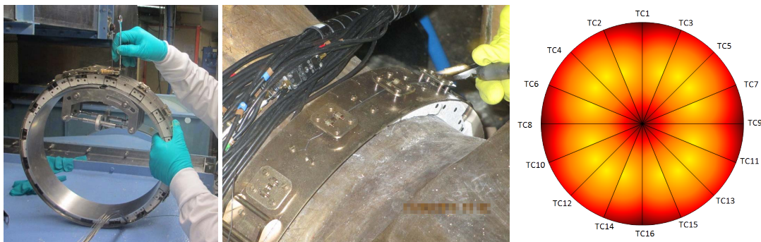
FIGURE 1.1 – Pose d'une ceinture de thermocouples EDF R&D (gauche) sur une tuyauterie de CNPE (milieu) et points de mesure associés (droite). Les thermocouples sont reliés à la station d'acquisition par 16 câbles visibles sur la figure centrale.
