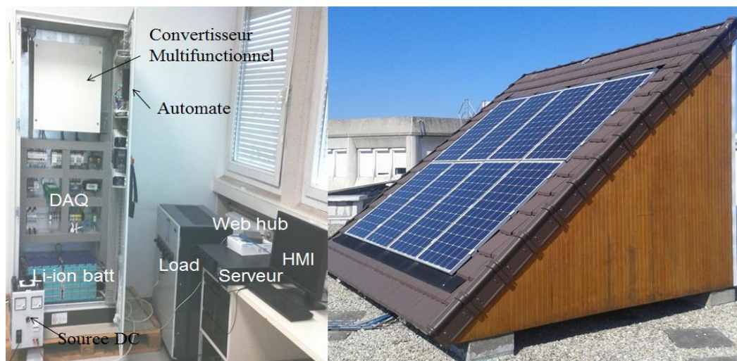
Figure V-21: Système expérimental installé à l'IUT de Créteil-Vitry
