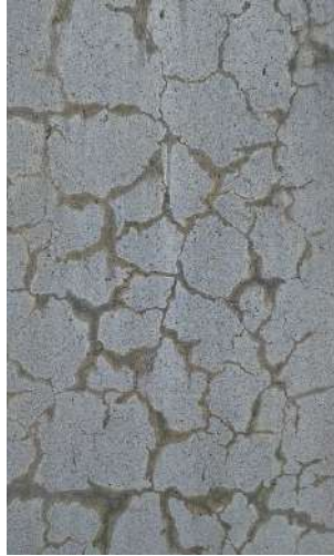
FIGURE C.6 – Faïençage typique de la surface d'un pilier de béton (Wikipedia, 2016)
