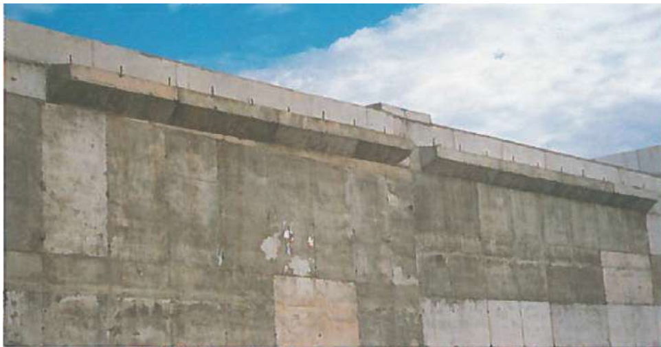
FIGURE C.7 – Variation de la teinte dû au réemploi anarchique de panneaux de coffrage (Geoffray, 1991)
