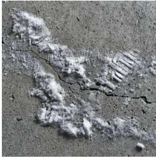
FIGURE C.9 – Efflorescences dans les bétons (Blasting, 2018)
