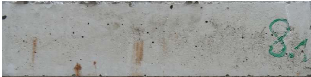
FIGURE C.10 – Traces de rouille sur une surface de béton 7 \times 7 \times 28 \text{ cm}^3
