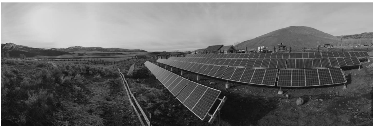
Figure 6 - Installation photovoltaïque du parc de Yellowstone (crédit photo : 3BL Media)
