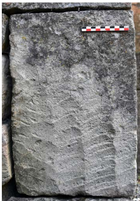
Fig. 27 – Traces de polka en ligne sur l'église de Montreuil-sur-Thonnance, 52 (cliché Cédric Moulis).
