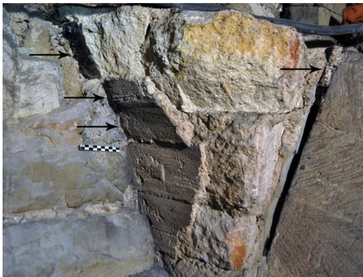
Fig. 51 – Fragments de bois piégés dans le voûtement du rez-de-chaussée de la tour-porche du prieuré de Varangéville (54), après arrachement des couchis lors du décintrage (cliché Cédric Moulis).
