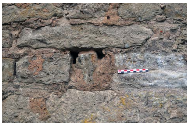
Fig. 20 – Trou de boudin maçonné, bouché grossièrement et tardivement, église de Flin, 54 (cliché Cédric Moulis).
