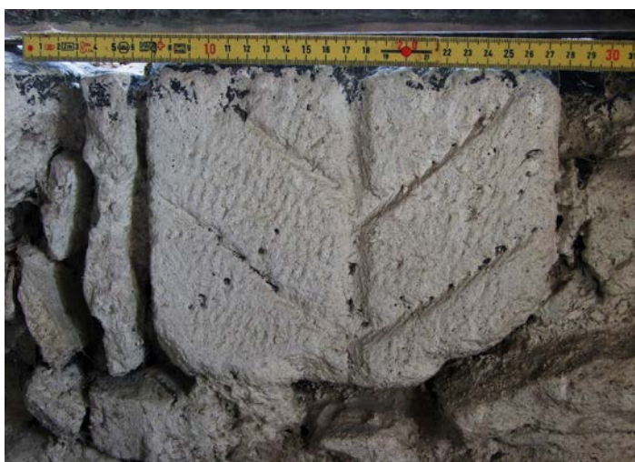
Fig. 44 – Voussoir en remploi présentant un abreuvoir, étage campanaire du clocher de Custines, 54 (cliché Cédric Moulis).
