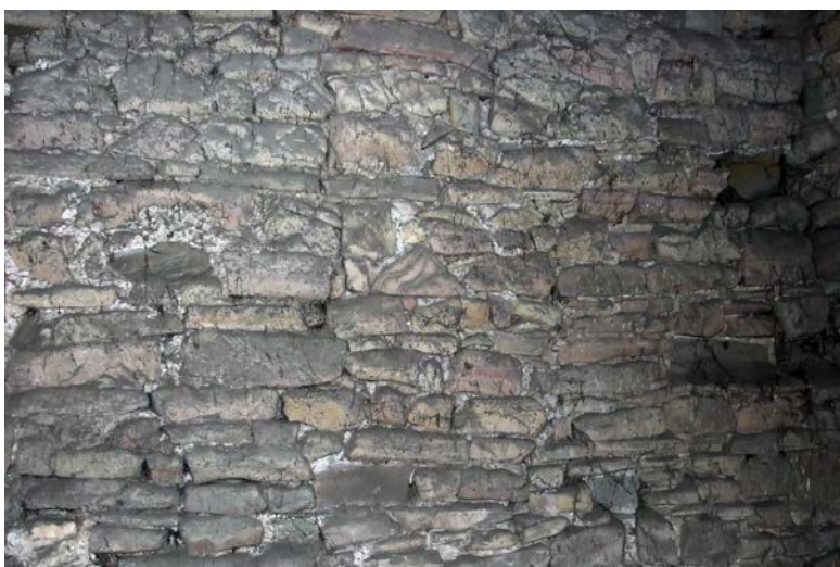
Fig. 36 – Paveint intérieur désorganisé, clocher de l'église de Mirecourt, 88 (cliché Cédric Moulis).
