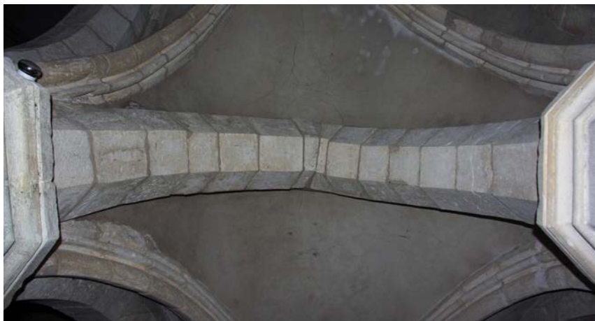
Fig. 53 – Arc brisé de section prismatique déformé lors de sa mise en tension, église d'Allamps, 54 (cliché Marion Subts).
