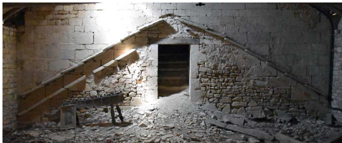
Fig. 24 – Deux solins se succèdent sur l'église d'Échenay (52). Le solin roman est celui du dessous, dont la partie droite est bûchée. Le solin en dessus est ajouté dans un second temps ; les pierres sont insérées dans une rainure pratiquée dans le mur (cliché Cédric Moulis).
