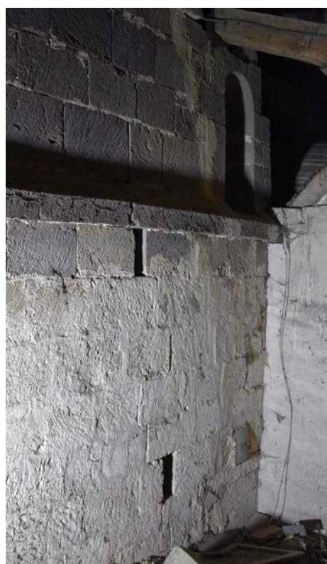
Fig. 4 – Trous de boulin maçonnés de forme rectangulaire, mur gouttereau de la nef de Gelvécourt-et-Adompt, 88 (cliché Cédric Moulis).
