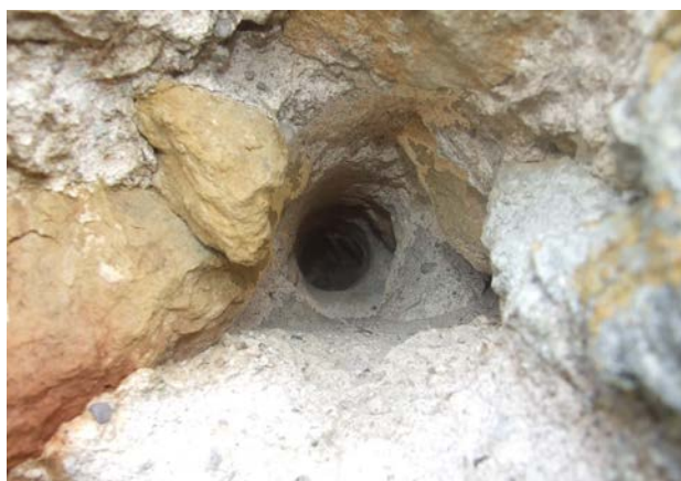
Fig. 12 – Gaine non parementée ; le boulin se trouve pris par le mortier et les pierres qui le bloquent, donjon de Vaudémont, 54 (cliché Cédric Moulis).
