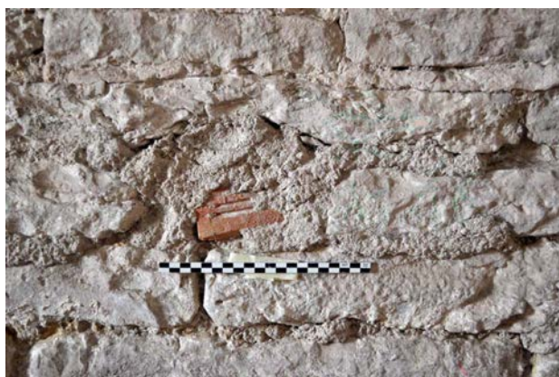
Fig. 23 – Trou de boulin bouché avec un fragment de brique creuse, chapelle de Xugney, 88 (cliché Cédric Moulis).
