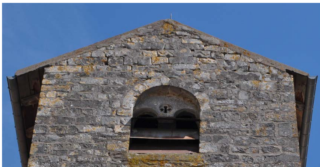
Fig. 12 – La toiture en bâtière du clocher de Puxe-Laloeuf (54) est un rehaussement postérieur, réalisé par des pierres de remploi, notamment des éléments de décor en zigzag (cliché Cédric Moulis).
