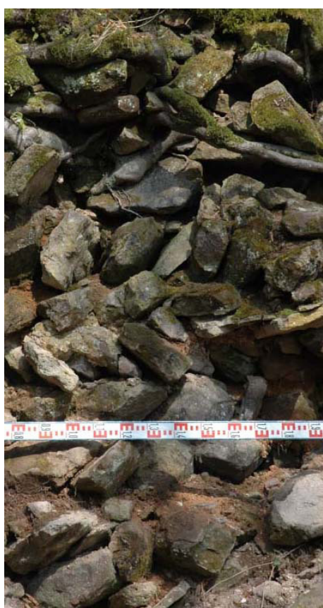
Fig. 52 – Blocage en épi de la tour sud aux tours Séchelles, 88 (cliché Charles Kraemer).
