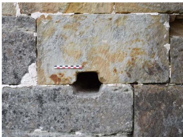
Fig. 9 – Trou de boulin dichotomique d'arête, chevet pentagonal de la chapelle de Xugney, 88 (cliché Cédric Moulis).
