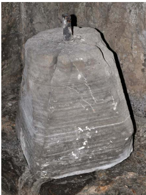
Fig. 10 – Chapiteau (ici à l'envers) présentant une fixation à son pilier par un goujon métallique (cliché Cédric Moulis).
