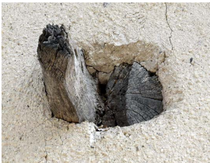
Fig. 5 – Extrémité d'un entrail de la charpente romane de l'église d'Allamps (54). On devine un assemblage à tenon-mortaise et deux trous de cheville à gauche (cliché Cédric Moulis).
