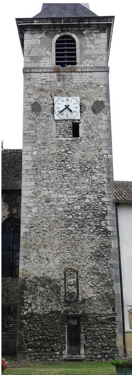
Fig. 34 – Enduit partiellement disparu recouvrant un appareil grossier, clocher de Pagny-sur-Moselle, 54 (cliché Cédric Moulis).
