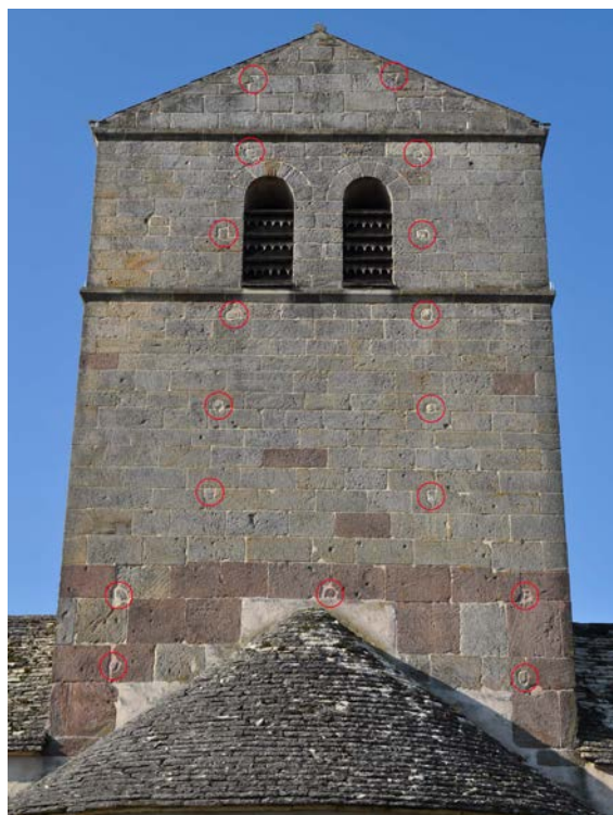
Fig. 19 – Trou de boulins rebouchés systématiquement sur le clocher de Gorhey, 88. On passe d'un échafaudage à trois perches arrimées à autant de boulins à un système à deux perches. Le changement, lisible dans la nature des pierres, pourrait correspondre à une reprise de chantier (cliché Cédric Moulis).
