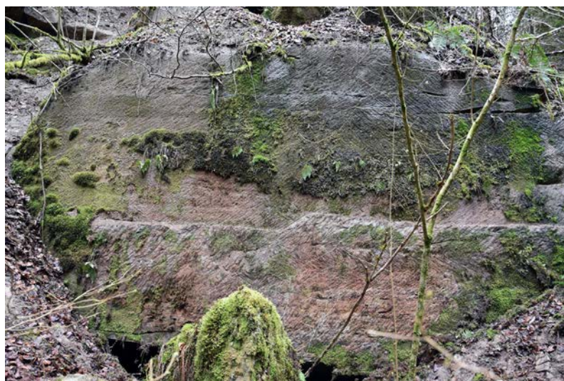
Fig. 29 – Val-et-Châtillon (54), paroi de 5 x 2,50 m, témoin d'une zone d'extraction potentiellement rattachée à la construction de l'abbaye de Haute-Seille (cliché Cédric Moulis).
