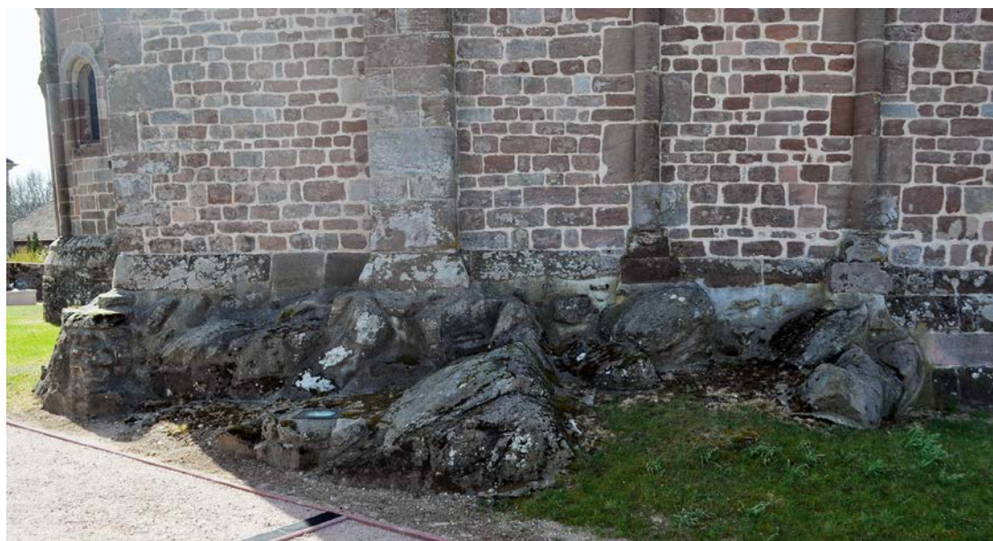
Fig. 15 – Une partie de l'église de Champ-le-duc (88) est fondée sur un affleurement gréseux (cliché Cédric Moulis).
