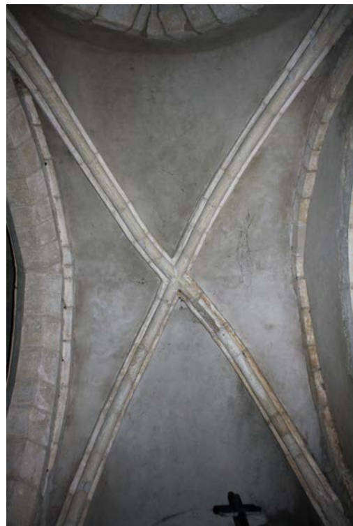
Fig. 52 – Croisée d'ogives moulurée déformée lors de sa mise en tension, église d'Allamps, 54 (cliché Marion Subts).
