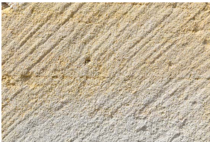
Fig. 22 – Layage à traces fines sur l'église de Mussey, 55 (cliché Cédric Moulis).
