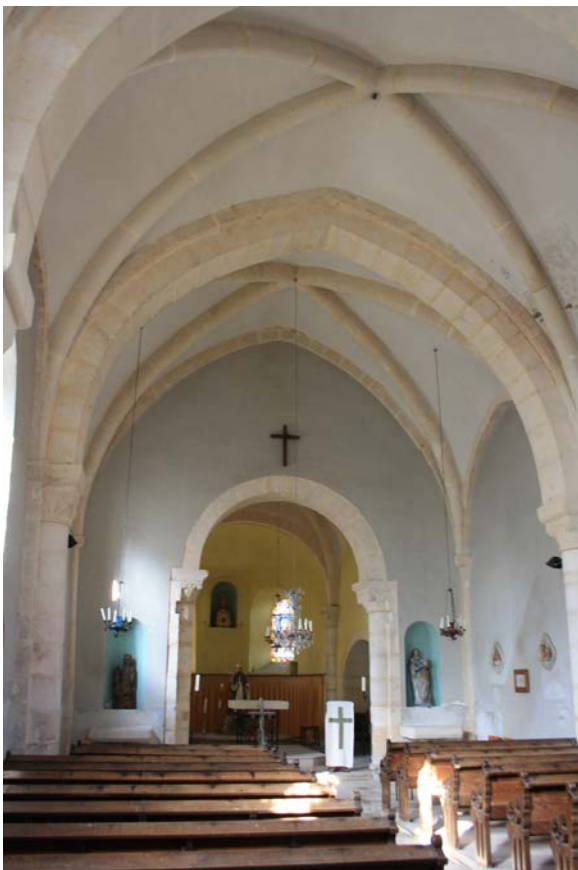
Fig. 18 – Arcs doubleaux brisés, nef de l'église de Gézoncourt, 54 (cliché Marion Subts).
