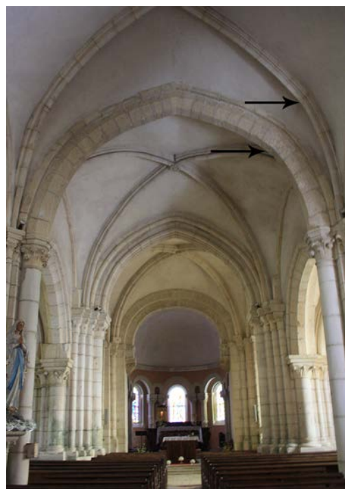
Fig. 54 – Déformation des arcs et voûtes dus au glissement vers la pente naturelle du relief, église d'Allamps, 54 (cliché Marion Subts).
