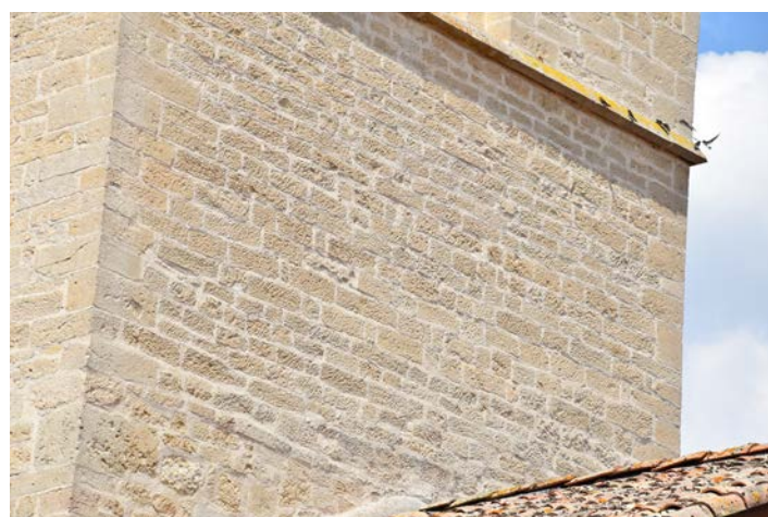
Fig. 34 – Les impacts d'outils du dégrossissage non réguliers à la taille de finition permettent d'accrocher la lumière différemment sur le clocher d'Andilly (54). En revanche, les chaînes d'angles sont dressées finement (cliché Marion Subis).
