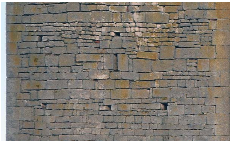
Fig. 44 – On remarque les pierres de petit calibre qui composent les assises autour des trous de boulin, clocher de Blénod-lès-Pont-à-Mousson, 54 (cliché Cédric Moulis).
