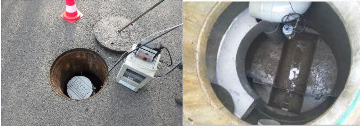
Figure 30 : Photos illustrant le prélèvement en réseau d'assainissement (à gauche une canalisation d'eaux usées et à droite une canalisation d'eaux pluviales). M.J. Capdeville (2015, rapport non publié)
