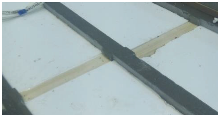
Figure V-41 : Positionnement des poutres à mi-portée des planchers dans le sens transversal des planchers
