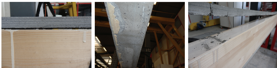
Figure V-15: Mauvaise exécution du collage pour la réalisation des poutres D et E (problème industriel)
