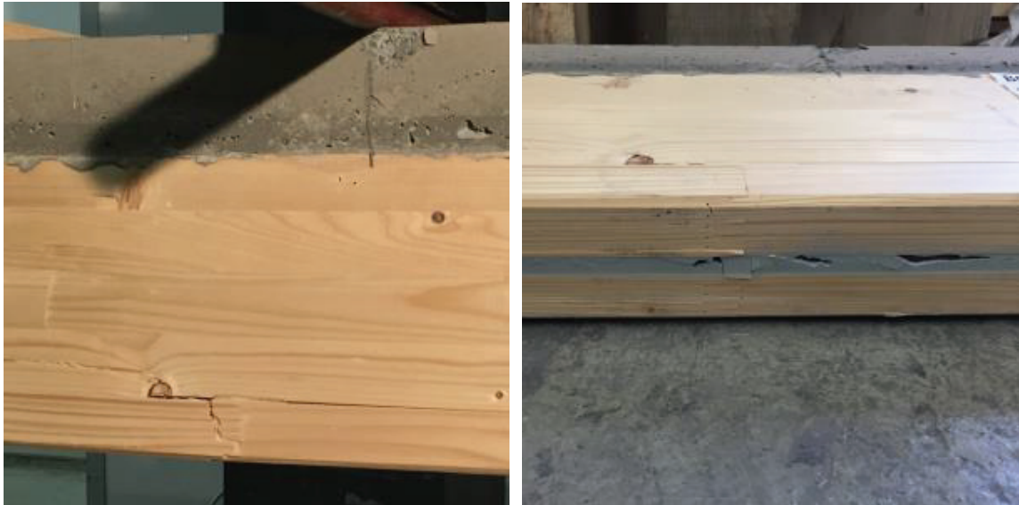
Figure V-30 : Rupture par flexion au niveau de l'aboutage du bois
