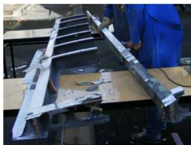
Figure 3.17 : Démontage de l'aile accidentée (aile A)
