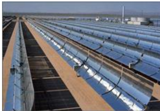
Figure I-8 : Centrale cylindro-parabolique SEGS VII. [37]
