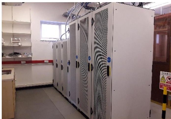
Figure 0-2 : Armoires contenant les amplificateurs de puissance destinés au contrôle du champ B_0 .
