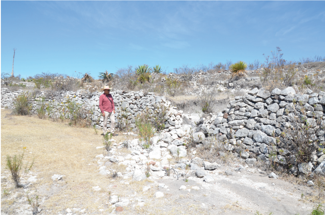
Figure 9 : Terrasse (Tepelmeme, Oaxaca) à l'abandon et partiellement détruite. La terre originellement soutenue par la terrasse est soumise à une forte érosion. Photographie Saumur 2015
