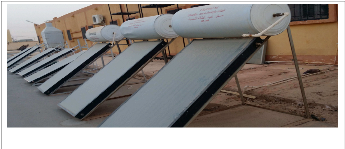
Figure 18 : chauffe-eau solaire à Ouargla (source auteur)
