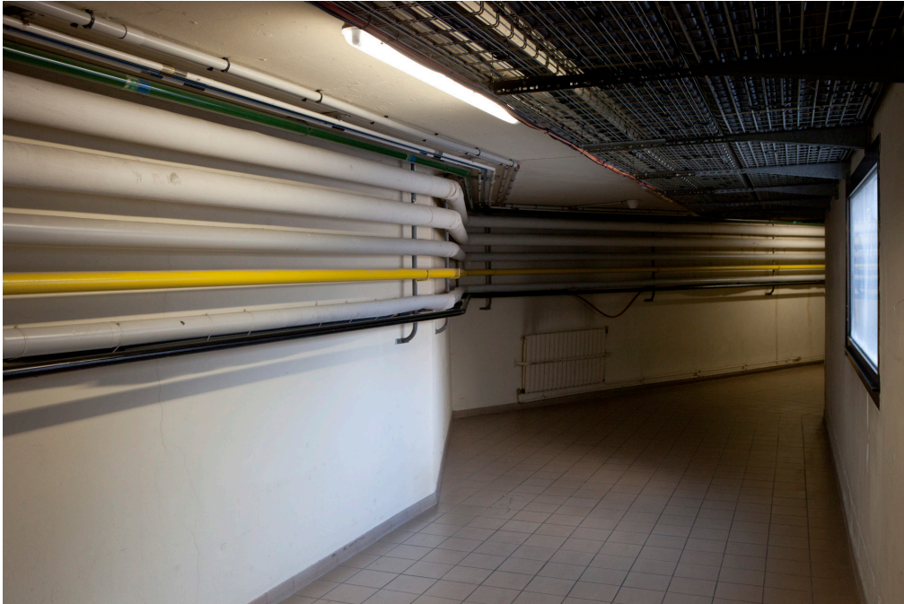
— fig.05 Sous-sols , Centre hospitalier Saint-Cyr, Villeuneuve-sur-Lot (2014).
