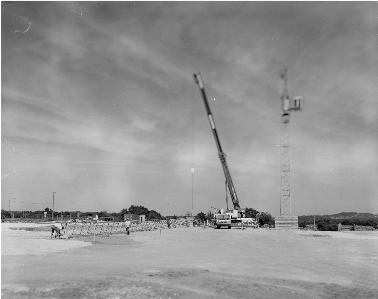
— fig. 02 Chantier du collège de Monflanquin, montage de la grue, Genius Loci Monflanquin.
