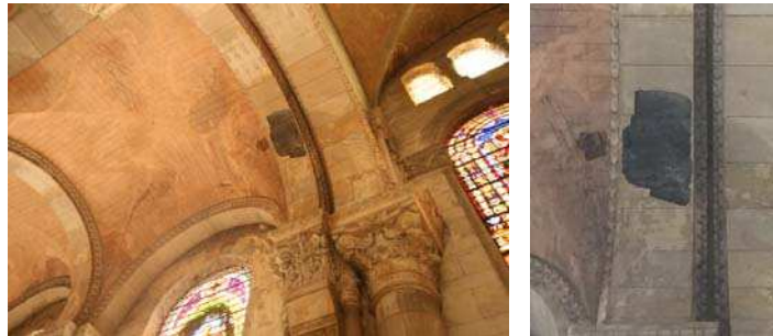
Figure 8.37 : Pisé de mâchefer visible sous l'enduit de décor des arcs doubleaux et briques visibles sous le décor peint des voûtes, église Saint-Nicolas, Givors.
