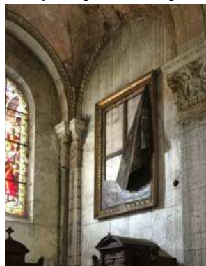
Figure 8.43 : Etat dégradé de l'une des toiles protégées de l'église Saint-Nicolas, Givors.
