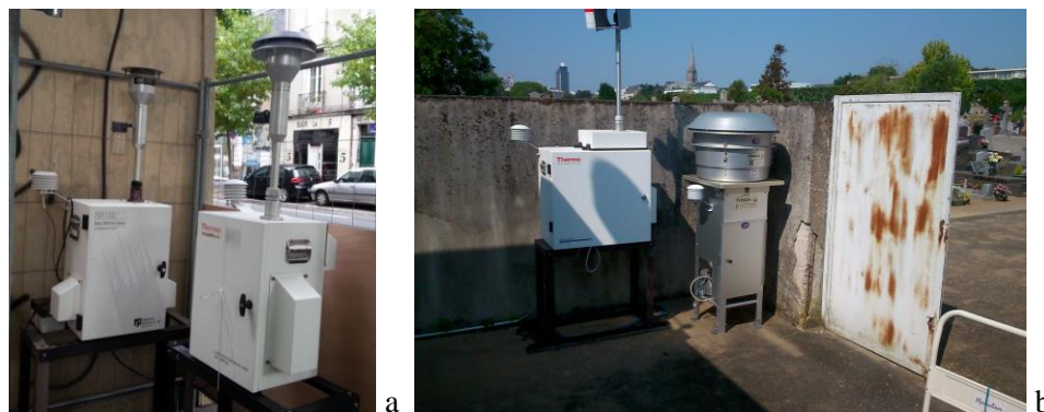
Figure 10 : Partisols installés sur le boulevard Victor Hugo (a) et préleveur à haut débit installé au Cimetière de la Bouteillerie (b)
