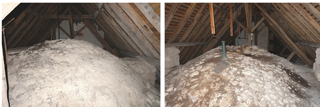
Figure 92: Extrados des voûtes de la nef : à gauche, travée orientale, à droite travée occidentale.
