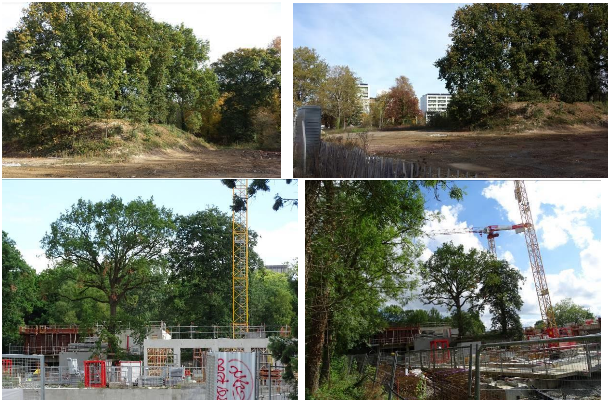
Photo 57 : Avant et Pendant la construction du pôle commercial de La ZAC (El Moualy, 2015 et 2018)
