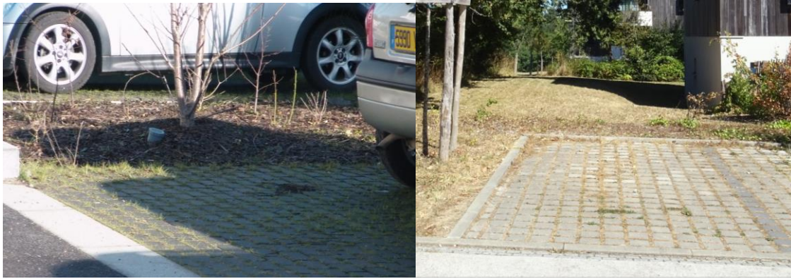
Photo 159 : pavés enherbés sur parking à La Courrouze et aux Perrières (El Moualy 2016)
