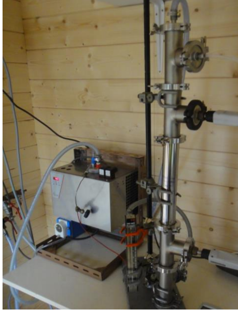
Figure 67. Sécheur par refroidissement « Peltier » du biogaz en entrée du réacteur.
