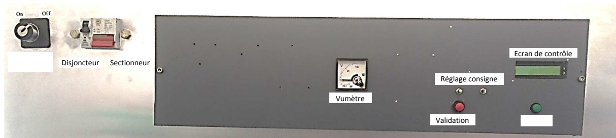
Figure 2.29 : Tableau de commande du système électrique
