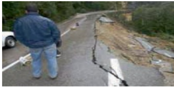
(b) Glissement de terrain (Aïn Drahem, Février 2012)
